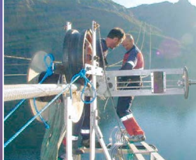
◀ Fjord Übergang in Norwegen Sunnalsfjord: 3 Spannweiten, max. 3.670 m Spannweite (436 kN RTS).
